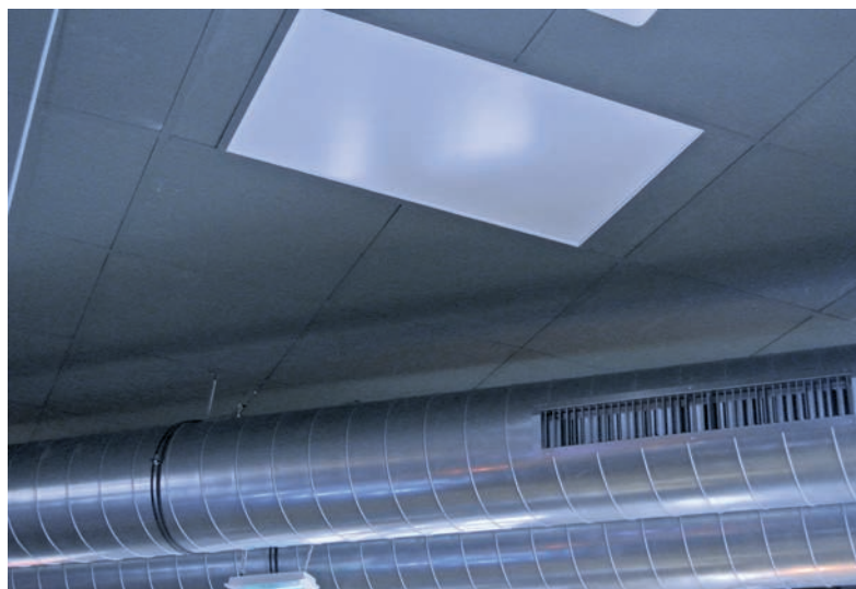
Acht Paneele ComfortPlus 2700 mit einer Leistung von je 1.350 Watt sind im Einsatz
