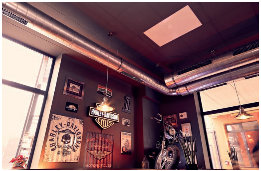
Die easyTherm-Heizpanele an der Decke des Fischer's American Restaurant sorgen für angenehme Temperierung der Räume.
