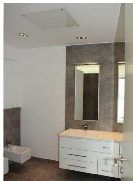
Diese Infrarotheizung in einer Wiener Villa wurde flächenbündig in die Decke verbaut.
